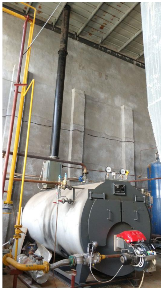
图 3-7 锅炉房 1.5t/h 沼气锅炉（备用）配 套另 1 根 8m 高排气筒
