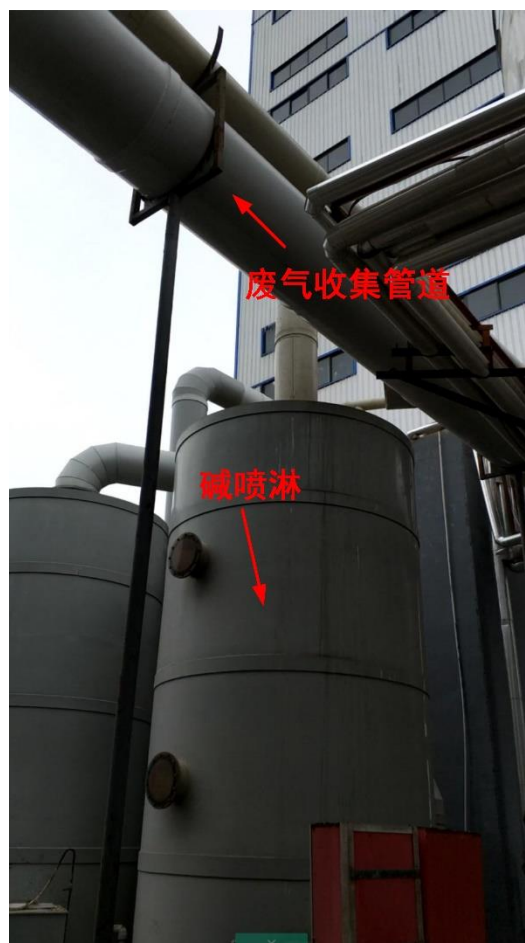
图 3-9 精馏车间东侧 碱喷淋塔
