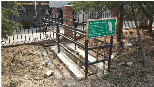
图 7-1 企业污水处理站 污水总排口
